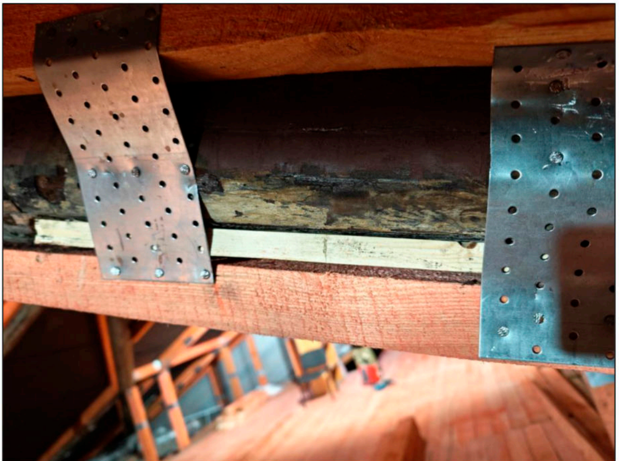
Фото 6. Общий вид трещины, заделанной герметиком, и крепление усиливающей доски.
