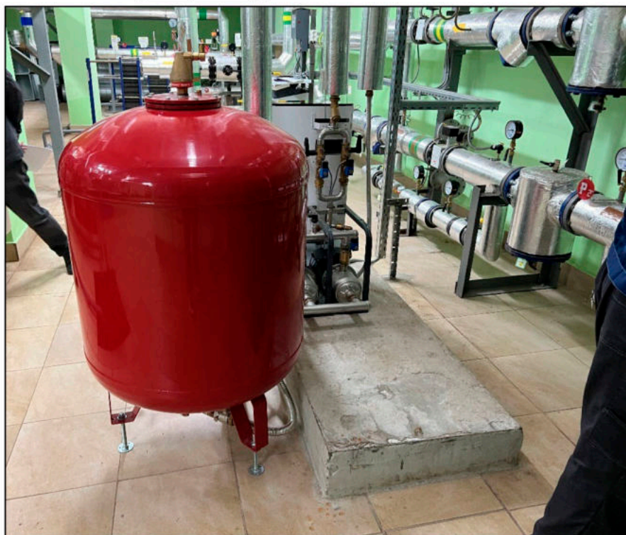
Фото 5. Расширительный бак с бетонной площадкой.
