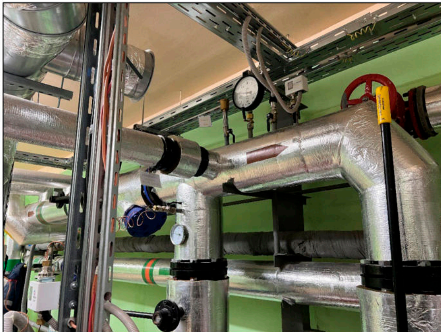
Фото 11. Данный манометр был поменян на DN=160 силами эксплуатирующей организации.
