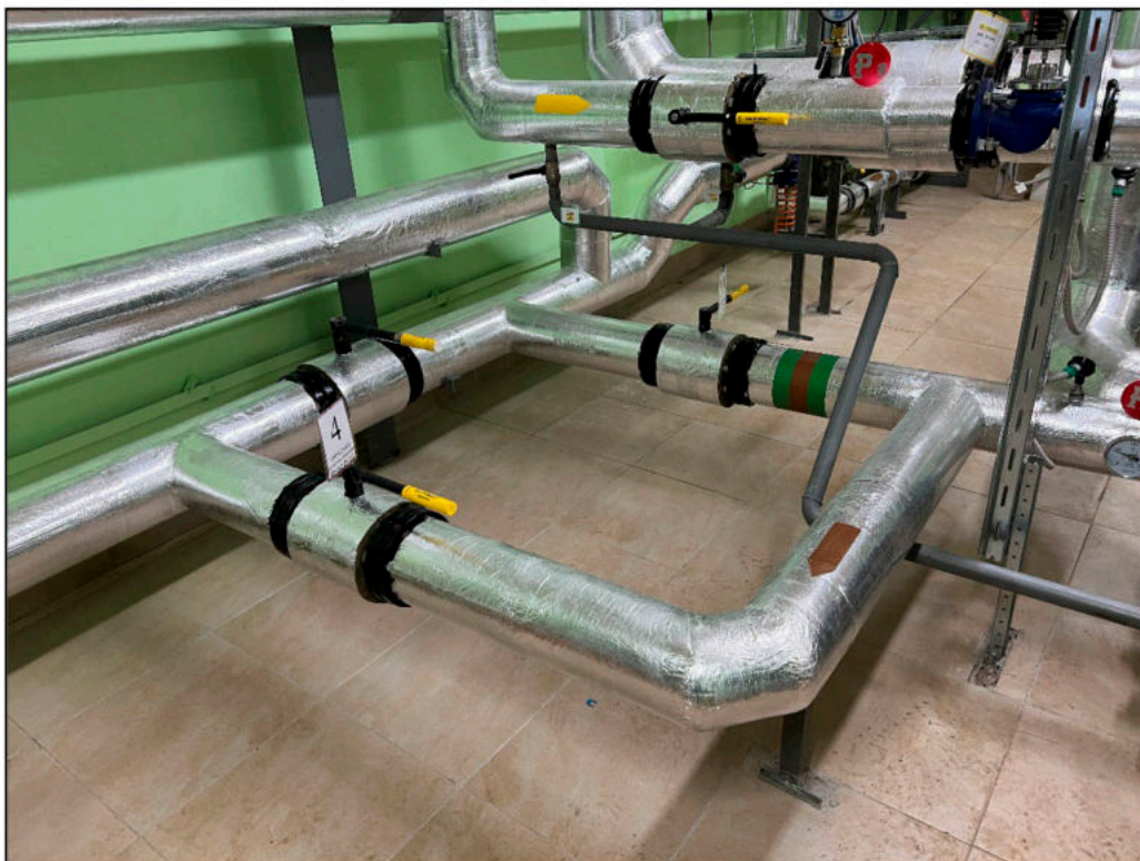
Фото 18. Узел, который отсутствует в Проектной документации.
