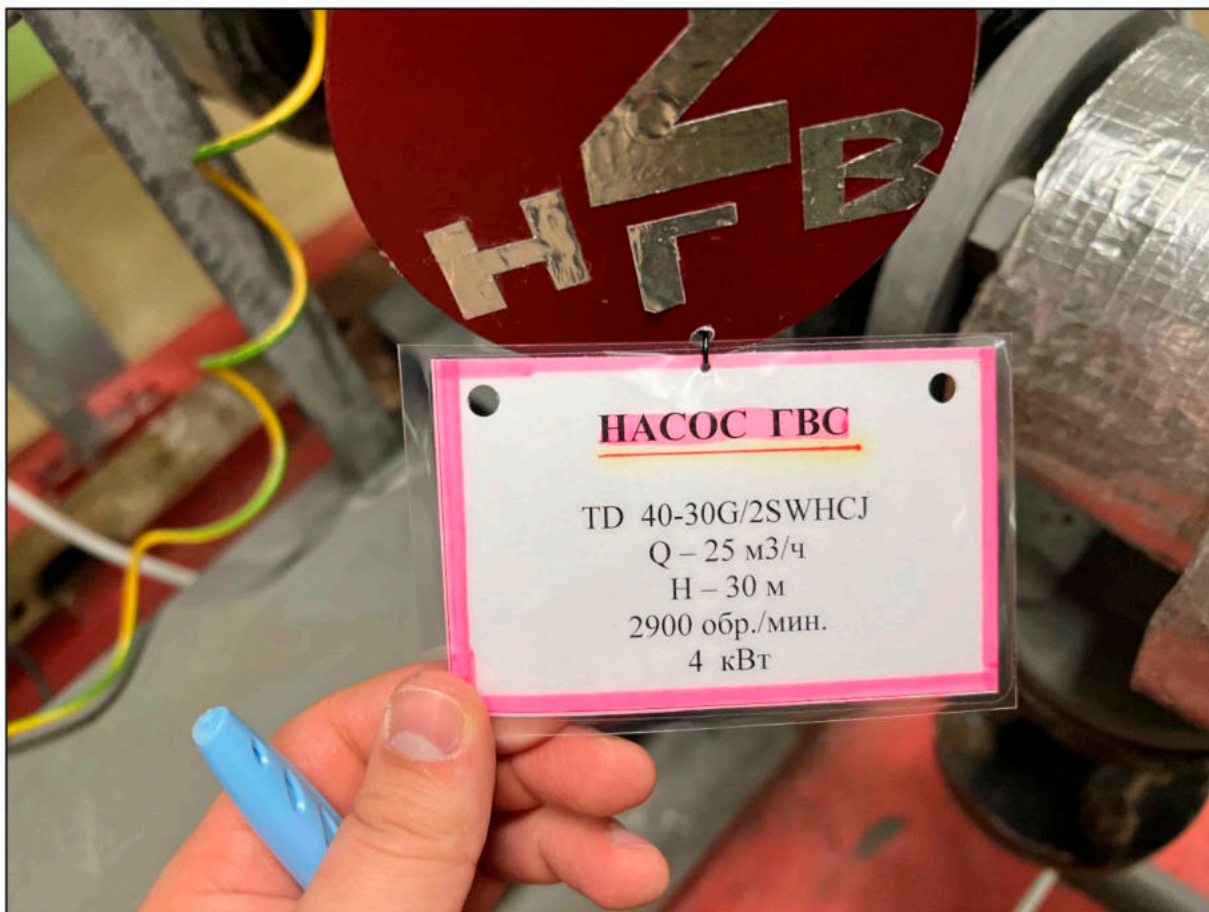
Фото 34. Насос циркуляционный ГВС №2.
