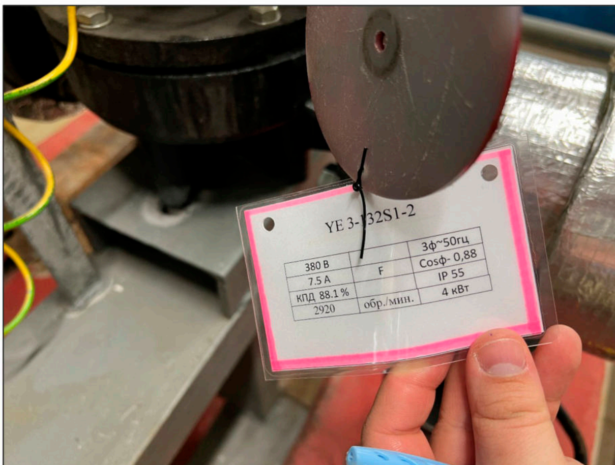
Фото 35. Насос циркуляционный ГВС №2.
