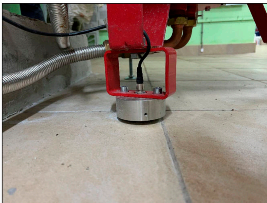
Фото 6. Датчик давление расширительного бака.
