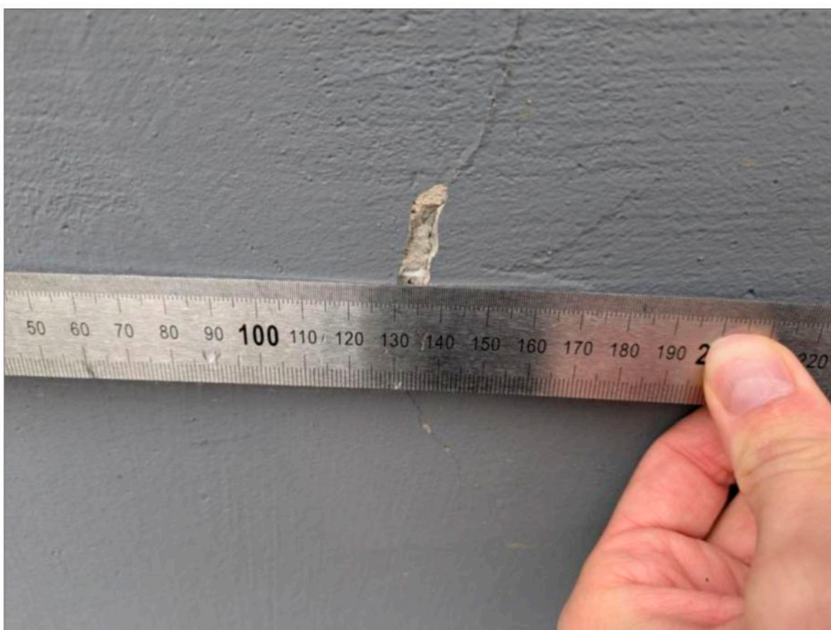
Фото 48. Трещины, сколы на окрашенной поверхности цоколя.
