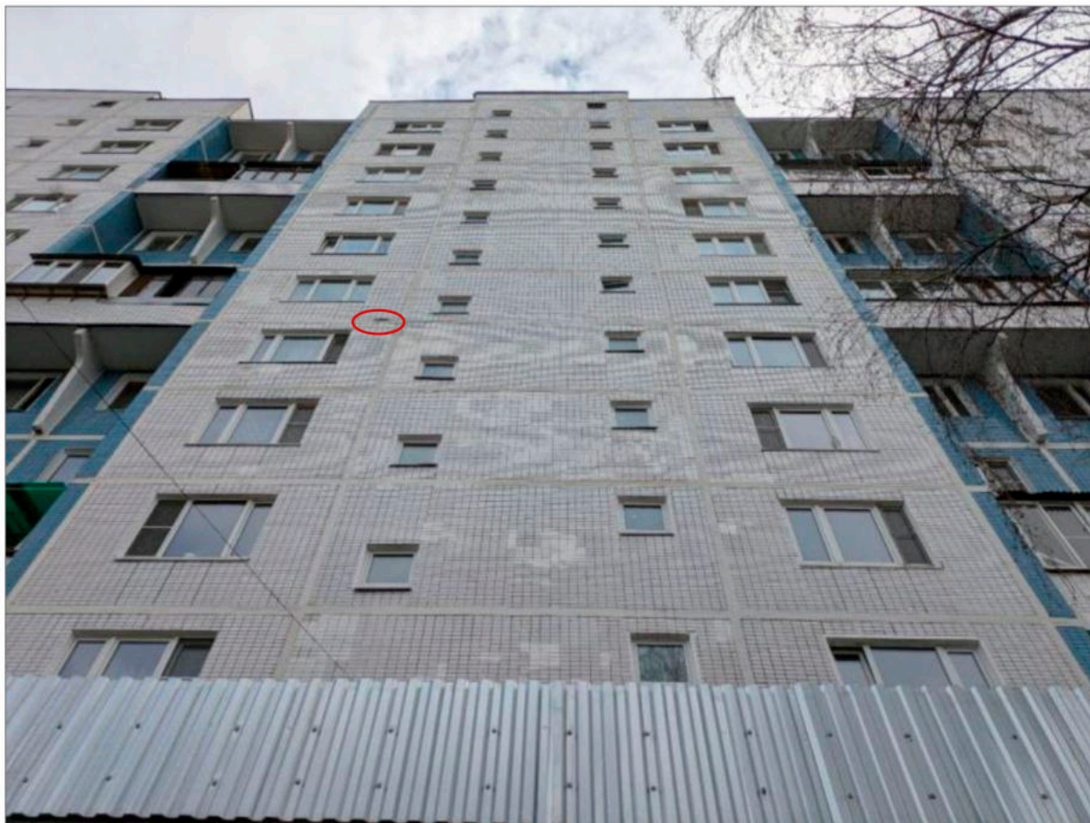
Фото 39. Отслоение, набухание межпанельных стыков.
