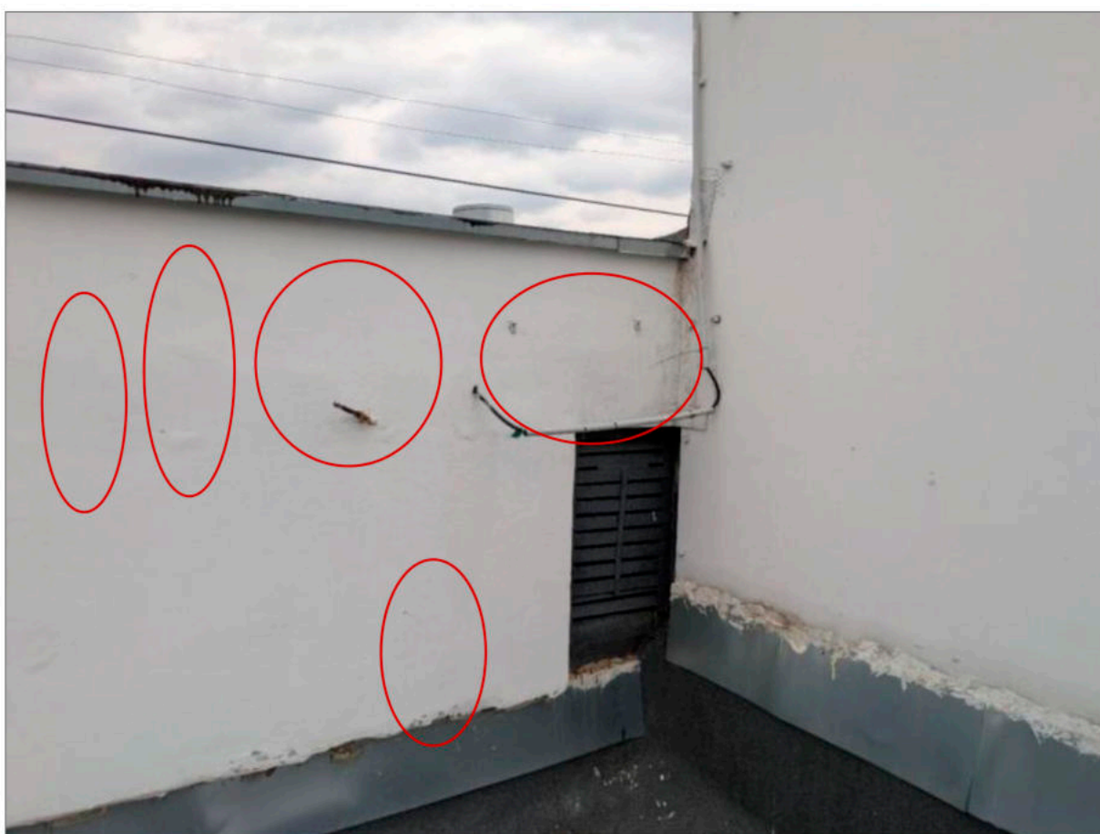
Фото 78. Трещины, полосы и пятна на окрашенной поверхности фасадов кровельных надстроек.
