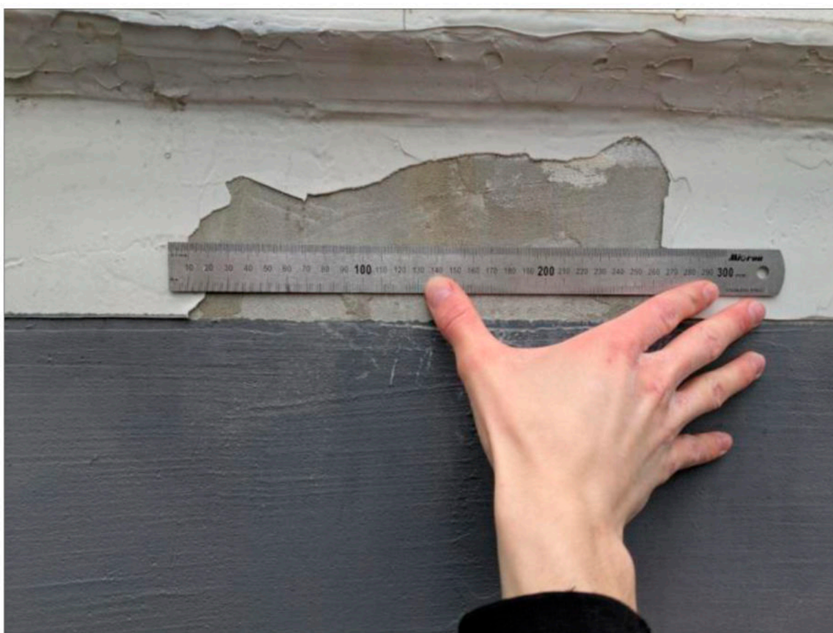
Фото 34. Разрушение межпанельных стыков.
