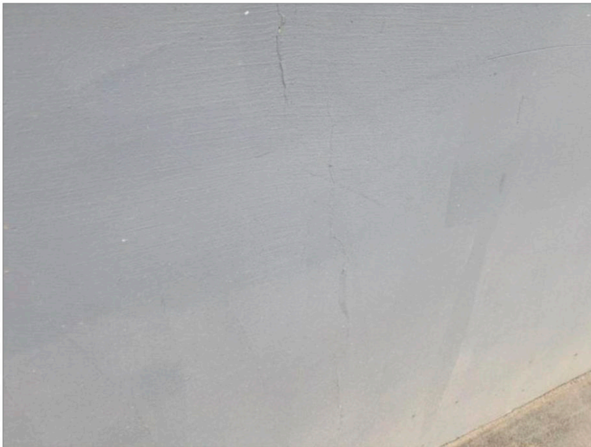
Фото 57. Трещины на окрашенной поверхности цоколя.
