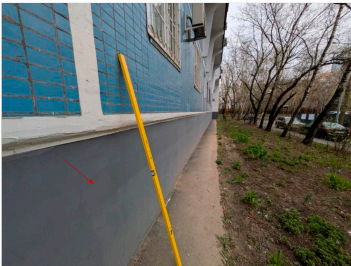
Фото 58. Трещины на окрашенной поверхности цоколя.
