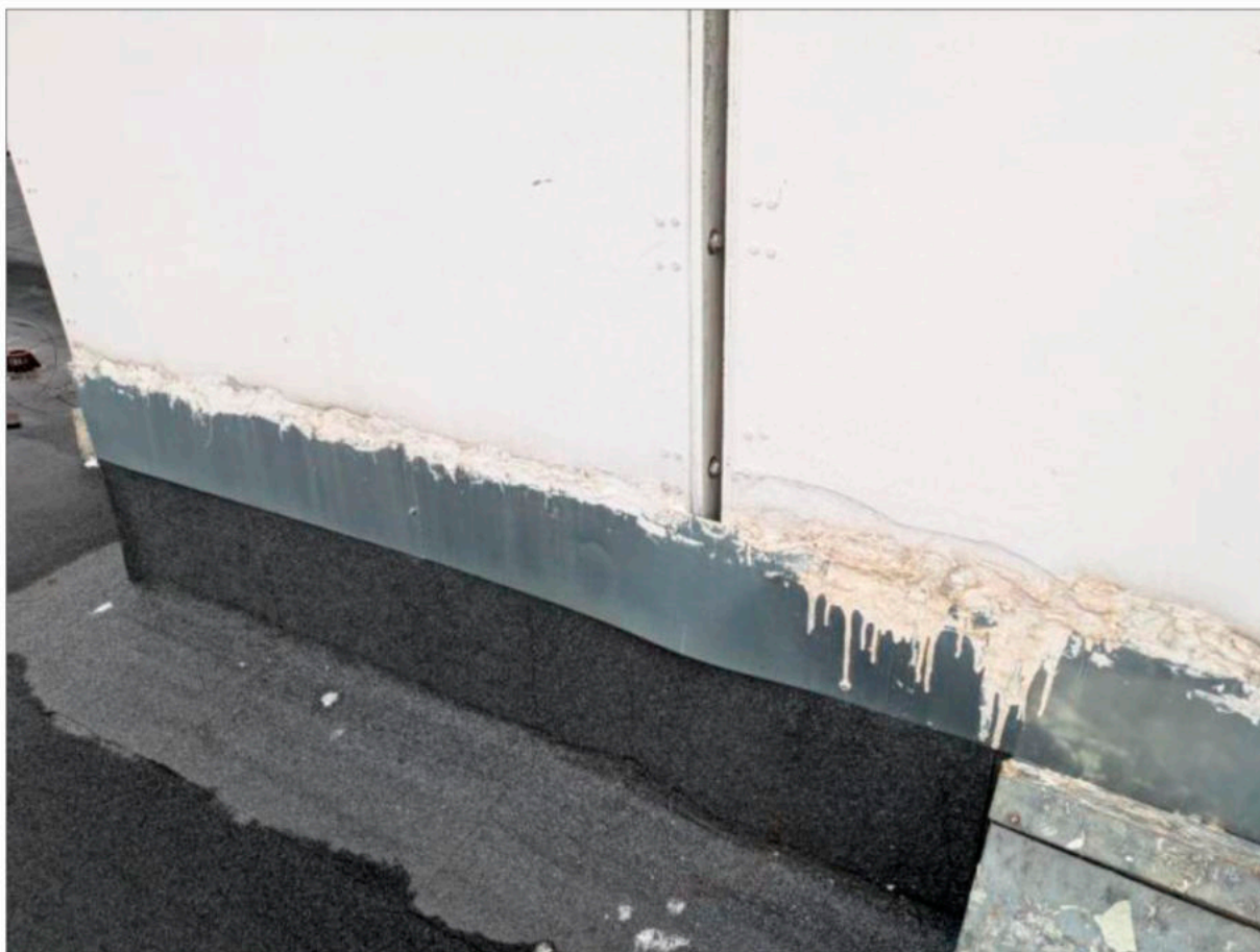
Фото 77. Полосы и пятна на окрашенной поверхности фасадов кровельных надстроек.
