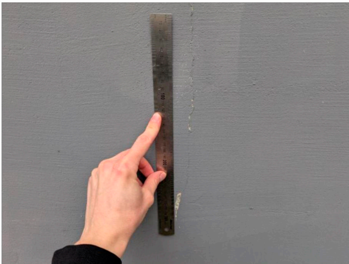
Фото 47. Трещины, сколы на окрашенной поверхности цоколя.
