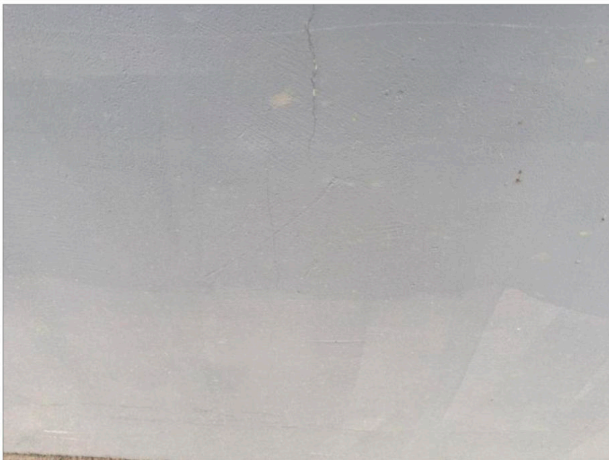
Фото 69. Трещины на окрашенной поверхности цоколя.
