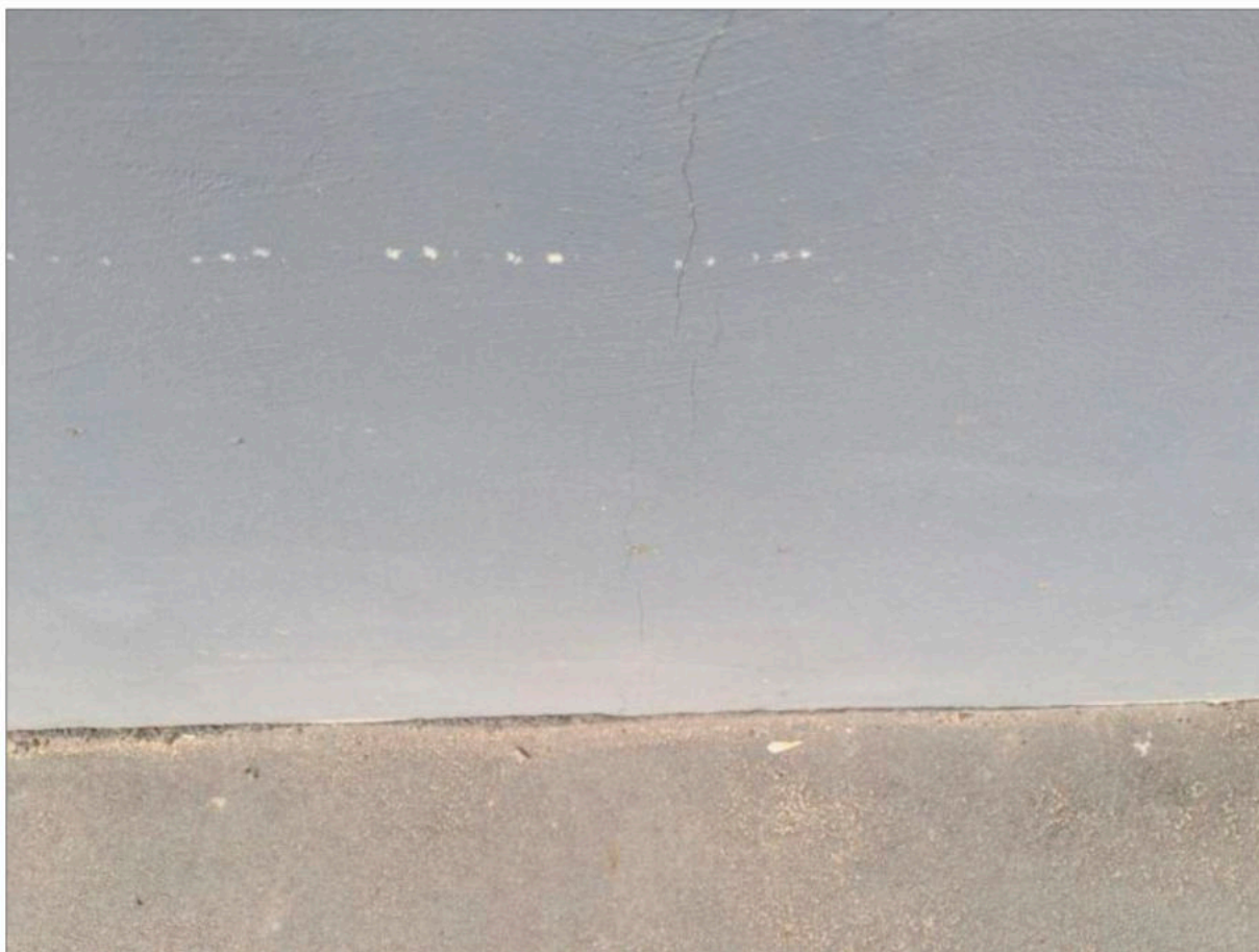
Фото 51. Трещины на окрашенной поверхности цоколя.
