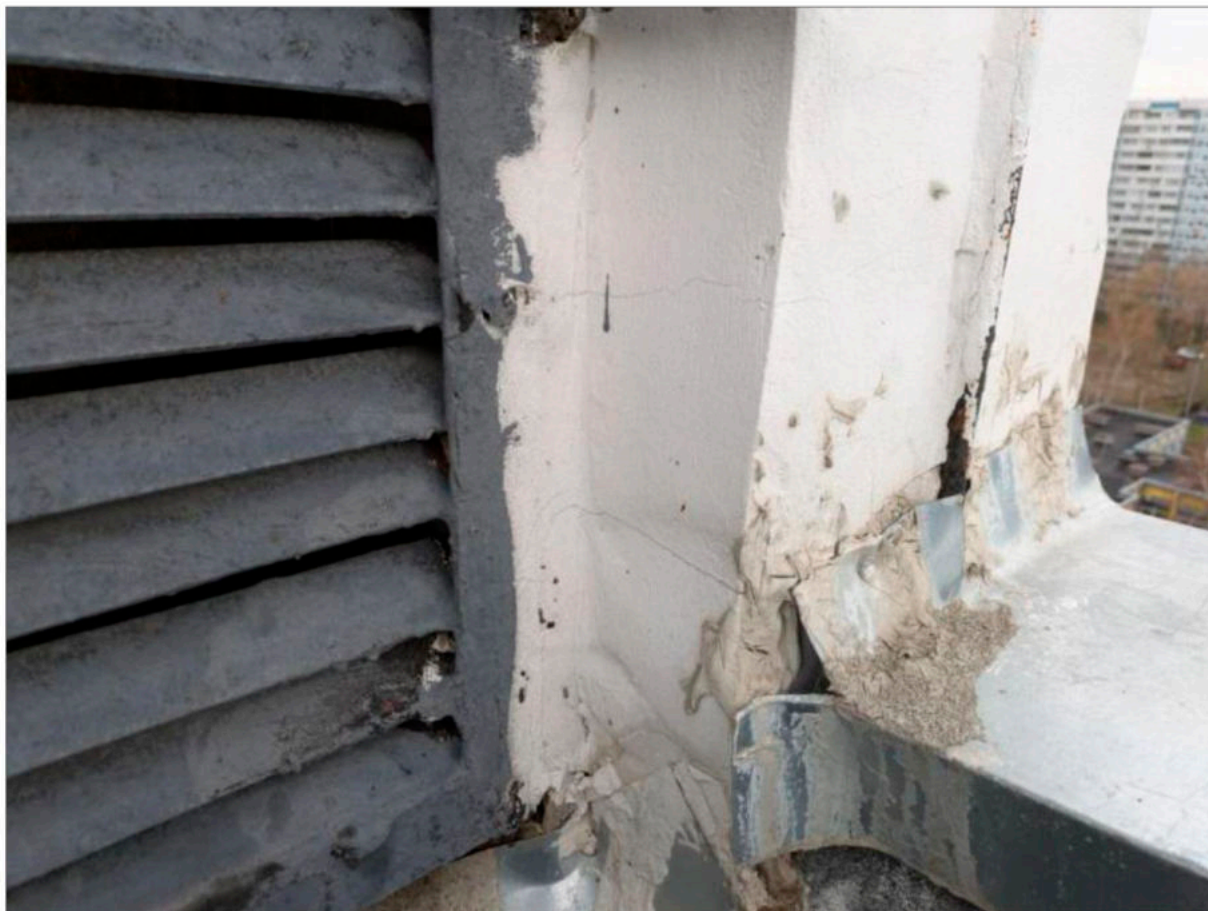
Фото 75. Трещины, полосы и пятна на окрашенной поверхности фасадов кровельных надстроек.
