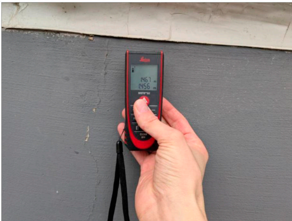
Фото 52. Трещины на окрашенной поверхности цоколя.
