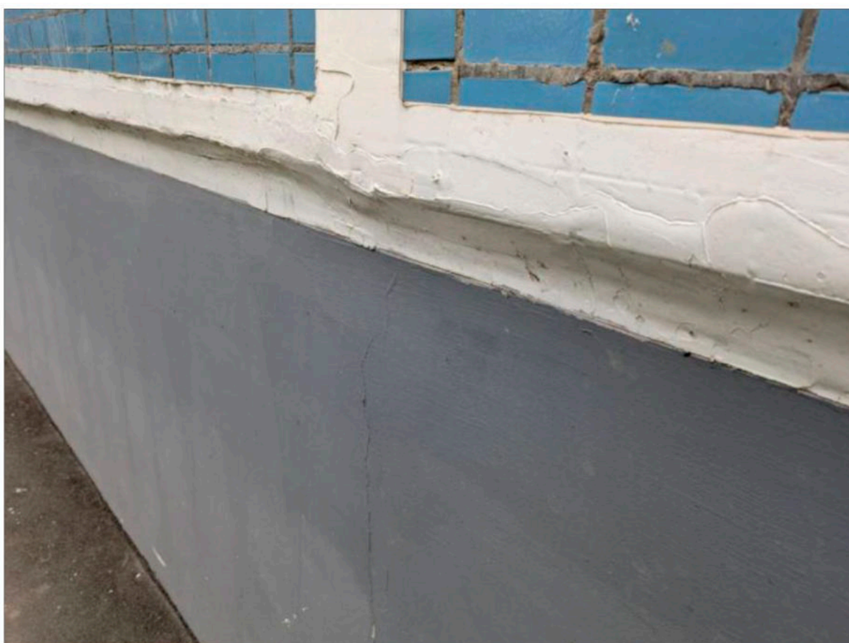
Фото 70. Трещины на окрашенной поверхности цоколя.
