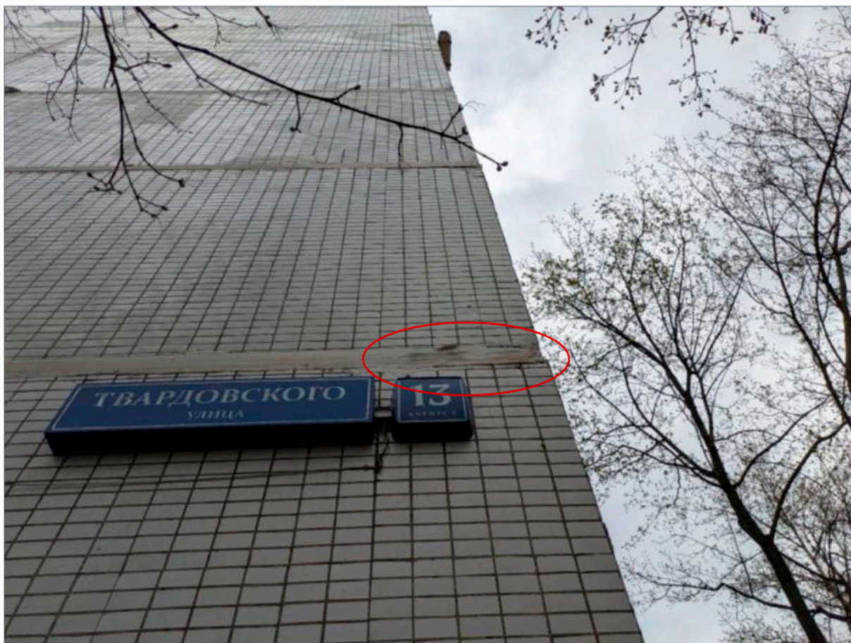
Фото 37. Отслоение, набухание межпанельных стыков.
