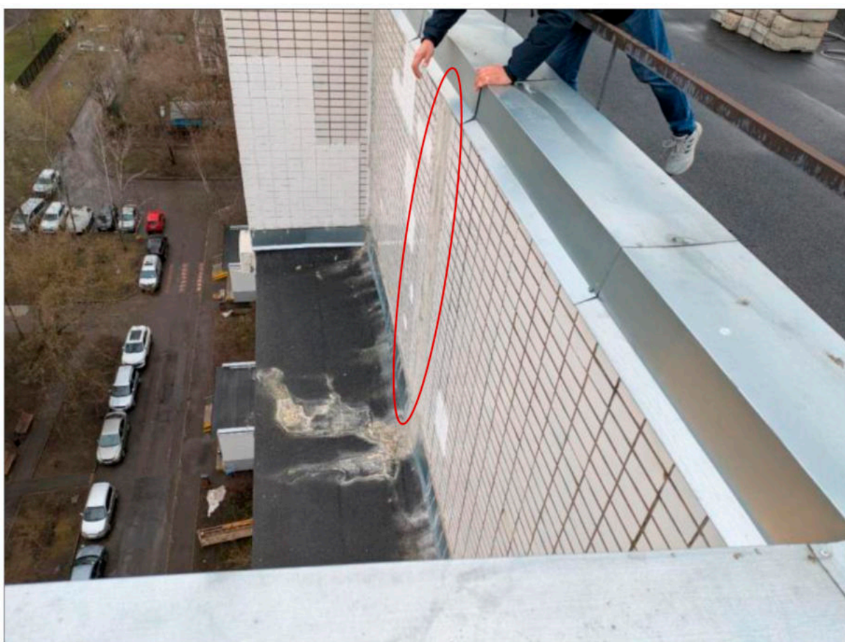
Фото 38. Разрушение межпанельных стыков.
