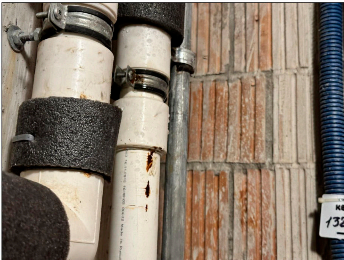
Фото 20. Место аварии в дату натурного осмотра, выявлена течь в системе ГВС.
