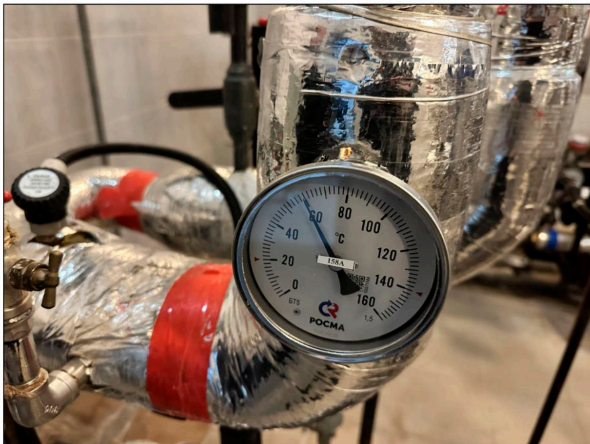
Фото 13. Показания температуры подачи теплоносителя (60 °C), ИТП жилой части №2. Блок 8 ИТП №2.
