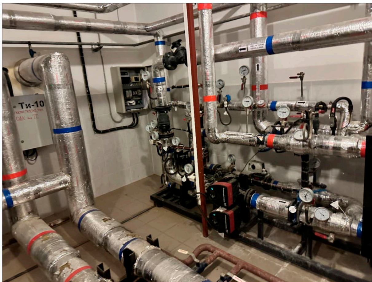
Фото 10. Общий вид ИТП жилой части №3. Блок 4 ИТП №3.
