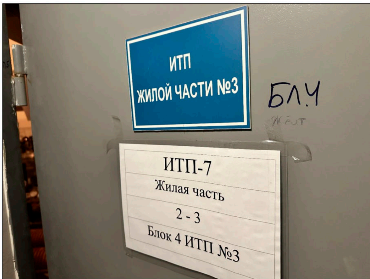
Фото 9. Входная дверь в ИТП жилой части №3. Блок 4 ИТП №3.
