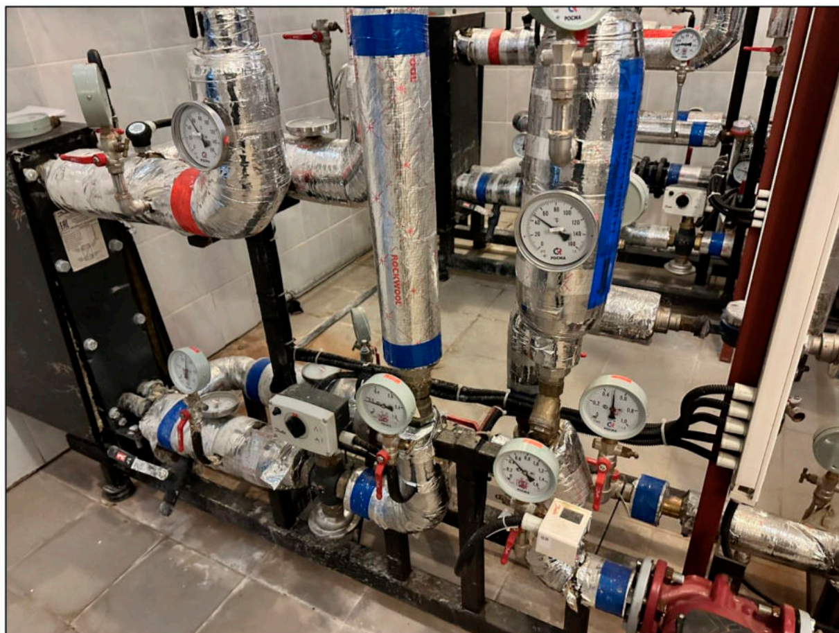
Фото 14. Общий вид значений измеряемых показаний, ИТП жилой части №2. Блок 8 ИТП №2.
