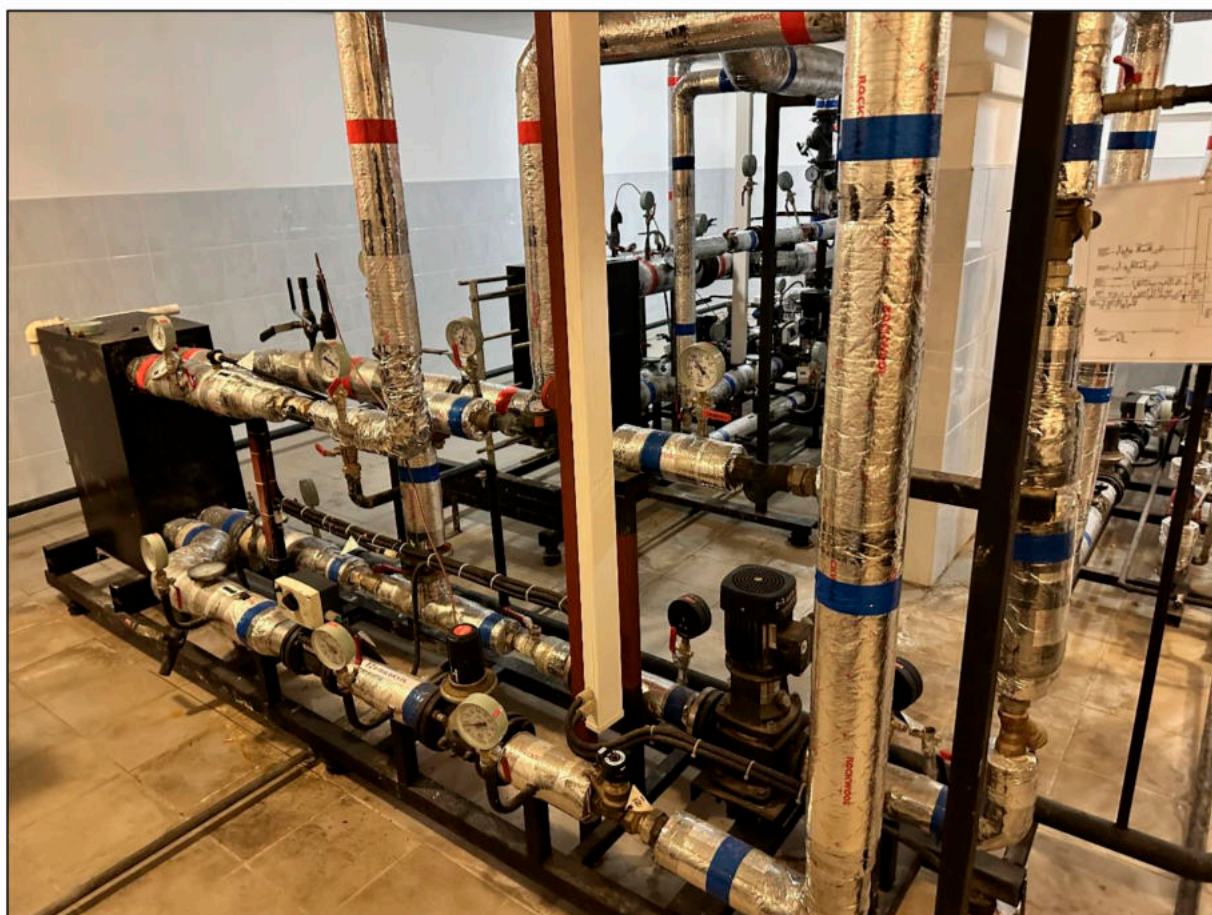
Фото 4. Общий вид ИТП жилой части №3. Блок 6 ИТП №3.
